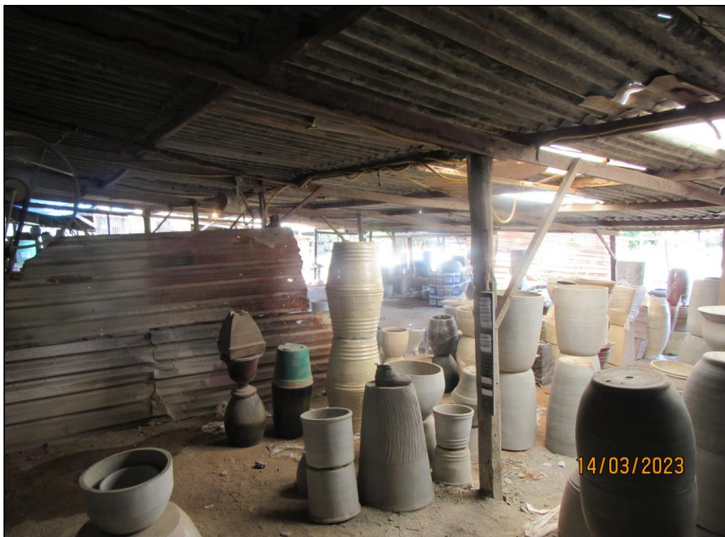
FOTO 07: Cobertura à direita do barracão da direita (sem valor).
