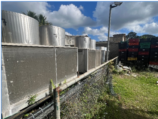
Foto 3 – Vista das torres de refrigeração junto a divisa de fundos
