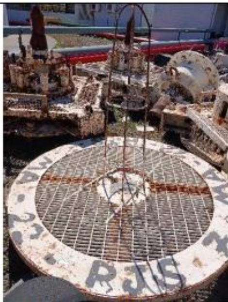
CAPA DE CORROSÃO
