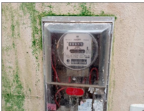
MEDIDOR DE ENERGIA ELÉTRICA
