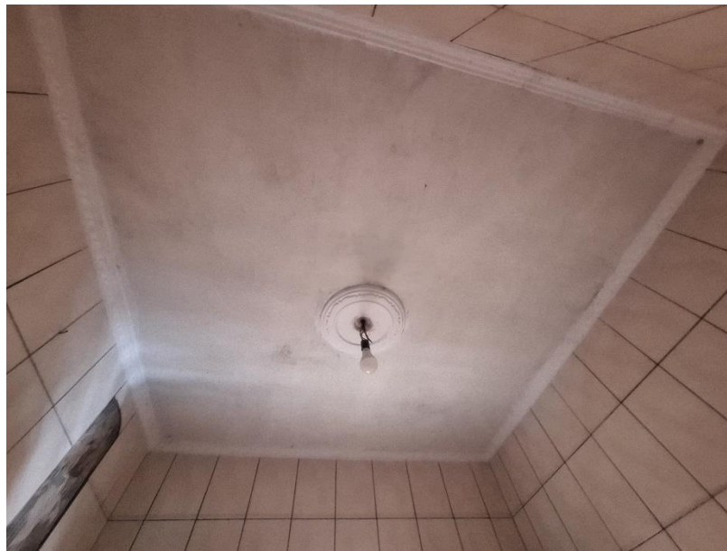
DETALHE DO FORRO DO BANHO SOCIAL COM SINAIS DE UMIDADE.
