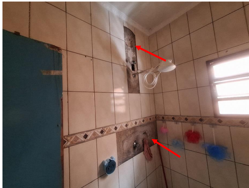
DETALHE DA PAREDE DO BANHO SOCIAL COM FALHAS NO REVESTIMENTO.
