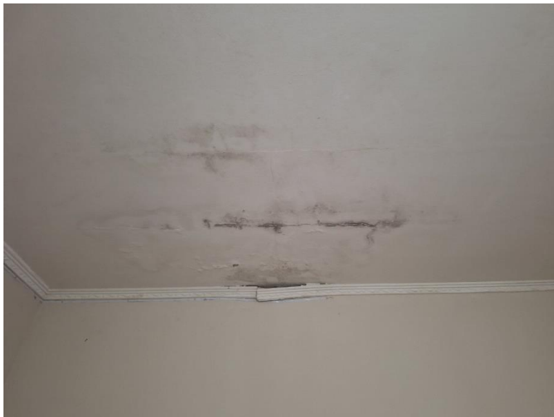
DETALHE DE FORRO DO DORMITÓRIO COM SINAIS DE UMIDADE.
