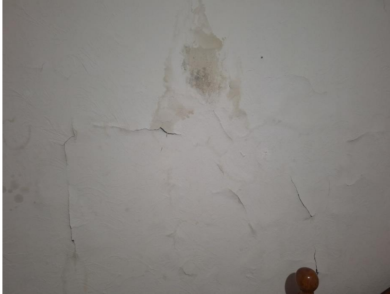
DETALHE DE PAREDE DO DORMITÓRIO COM SINAIS DE UMIDADE.
