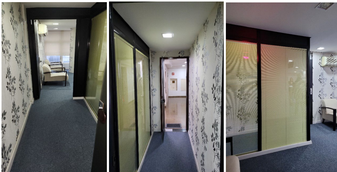
Vista parcial corredor de acesso ao conjunto 42 e detalhe de divisória de vidro com persiana embutida
