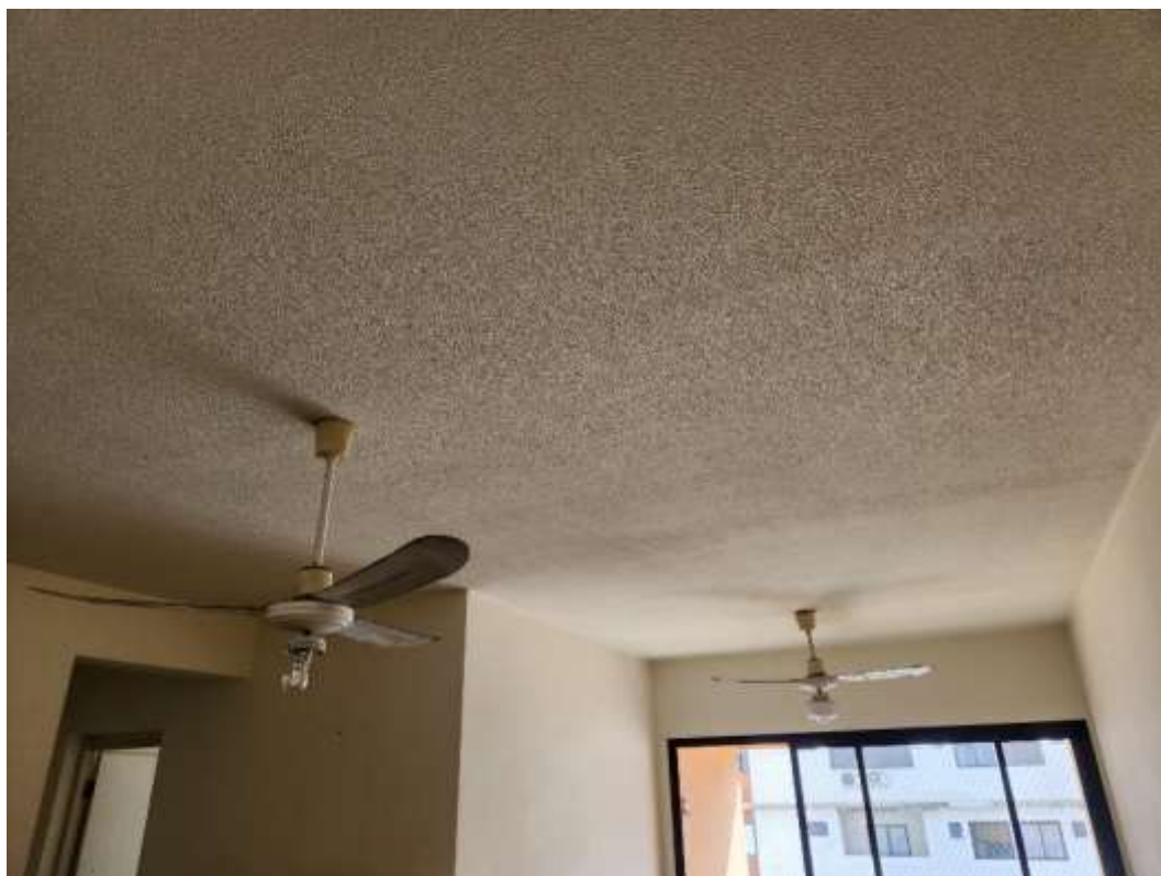
Teto da sala com pintura texturizada.
