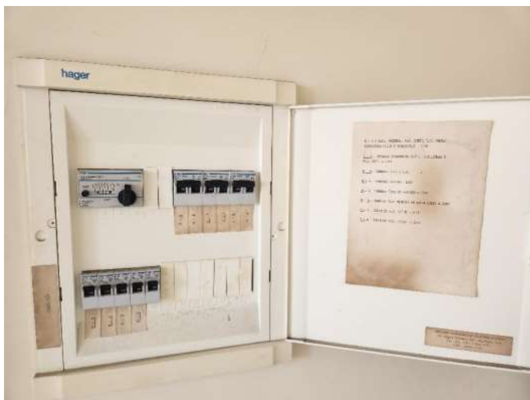
Quadro de distribuição de energia elétrica.
