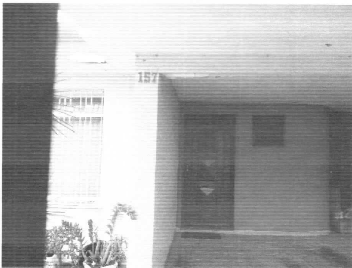
FOTO 03: Detalhe do número da edificação e da pintura da fachada "descascando".
