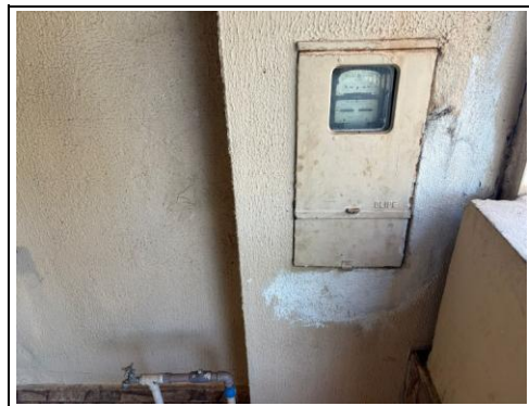
MEDIDOR DE ENERGIA ELÉTRICA
