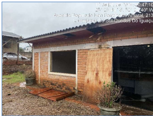
Foto 8: vista da entrada da área administrativa e escritório. Falta de manutenção e mau estado de conservação da cobertura, forros, falta de esquadrias de janeladas.
