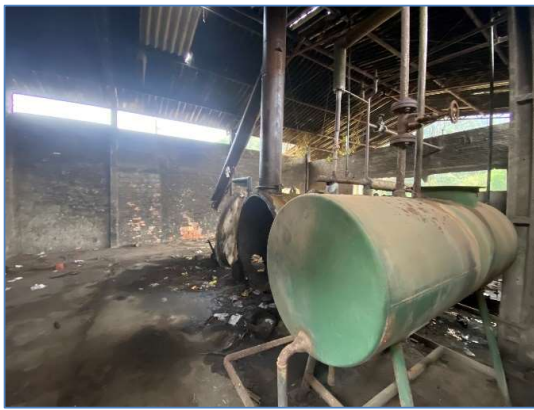
Foto 47: vista interna da casa da caldeira, mau estado de conservação, telhas trincadas, infiltrações.
