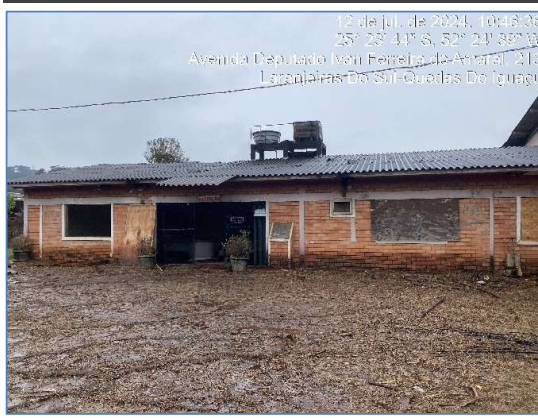
Foto 6: vista da entrada da área administrativa e escritório. Falta de manutenção e mau estado de conservação da cobertura, falta de esquadrias de janeladas.
