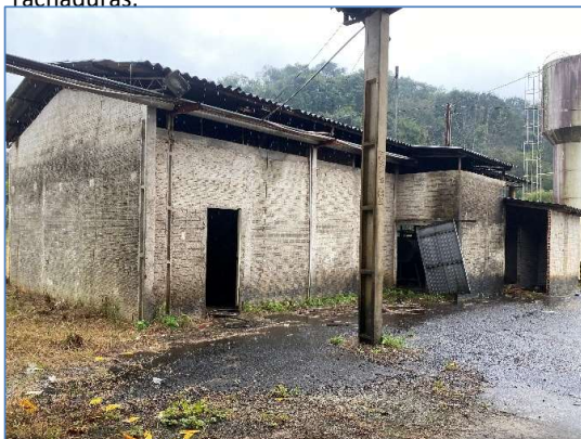
Foto 45: vista da casa da caldeira e oficina, mau estado de conservação, falta de acabamentos, infiltrações.
