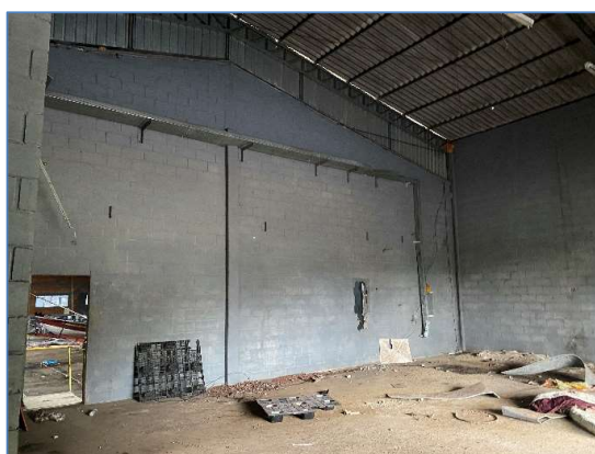
Foto 40: vista interna do galpão/barracão, mau estado de conservação, infiltrações, pisos danificados.
