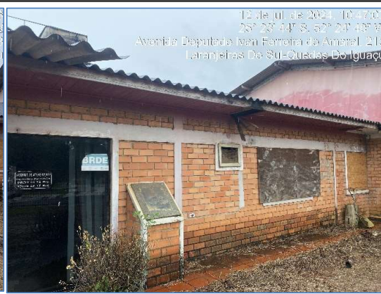
Foto 7: vista da entrada da área administrativa e escritório. Falta de manutenção e mau estado de conservação da cobertura, forros, falta de esquadrias de janeladas.
