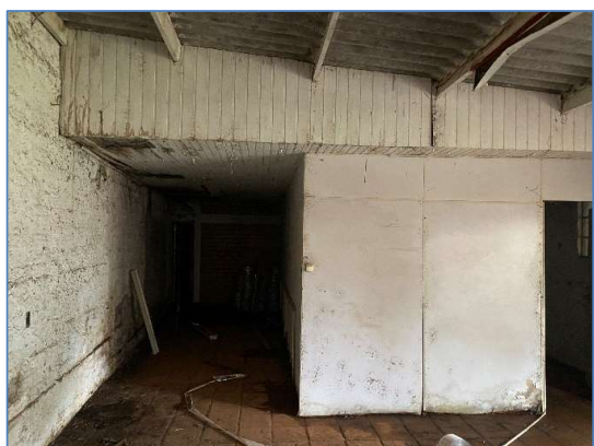
Foto 28: vista do salão, deterioração dos revestimentos e pisos, infiltrações, falta de conservação e manutenção.
