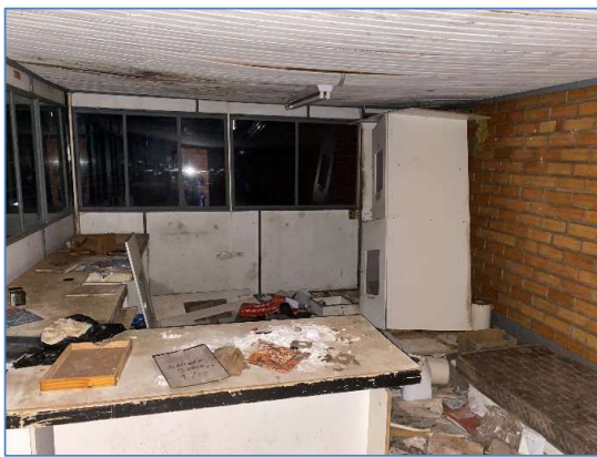
Foto 12: vista interna da área administrativa. Danos nos forros, infiltrações, falta de manutenção, mau estado de conservação.
