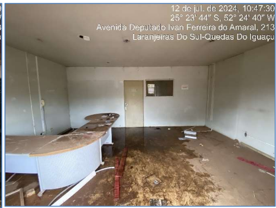
Foto 9: vista interna da área administrativa. Falta de manutenção e mau estado de conservação das paredes, forro e pisos, infiltrações.
