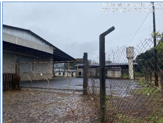
Foto 5: vista do avaliando. Falta de manutenção e mau estado de conservação das cercas e alambrados.
