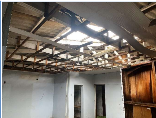
Foto 15: vista interna da área administrativa. Danos nos forros, danos no telhado, deterioração do madeiramento, mau estado de conservação.
