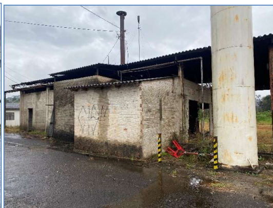
Foto 46: vista da casa da caldeira e oficina, mau estado de conservação, falta de acabamentos, infiltrações.
