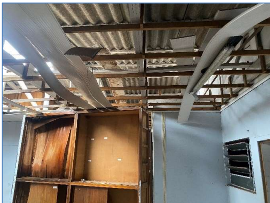
Foto 16: vista interna da área administrativa. Danos nos forros, danos no telhado, deterioração do madeiramento, mau estado de conservação.
