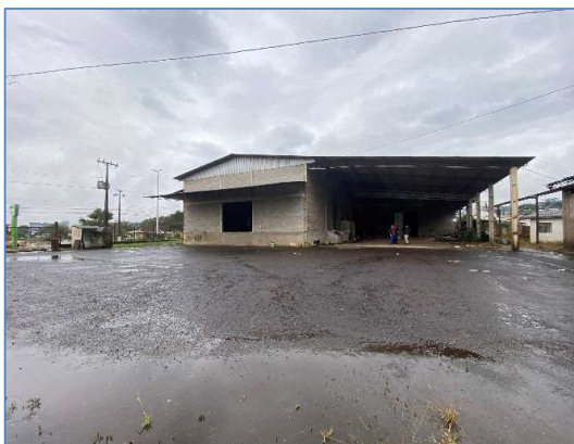
Foto 34: vista do galpão/barracão e cobertura anexa, mau estado de conservação.
