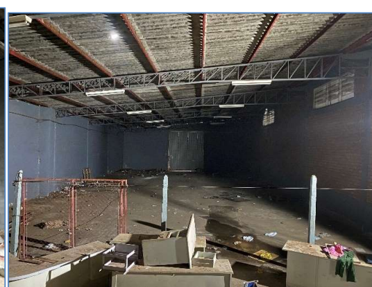
Foto 41: vista interna do galpão/barracão, mau estado de conservação, infiltrações.
