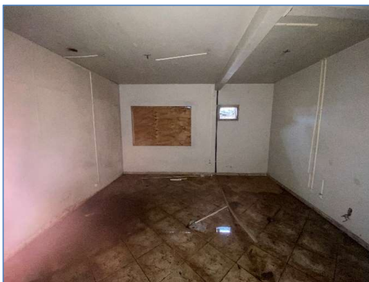
Foto 18: vista interna da área administrativa. Danos infiltrações generalizadas, falta de esquadria de janela, mau estado de conservação.
