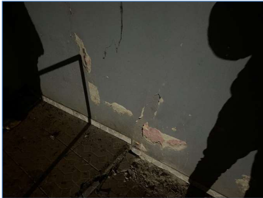
Foto 43: vista interna do galpão/barracão, mau estado de conservação, infiltrações, danos no reboco, rachaduras.
