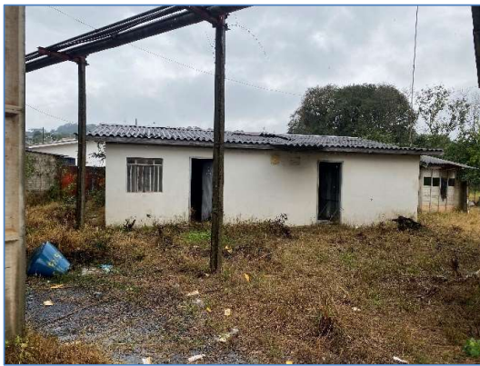
Foto 30: vista do vestiário e guarita, falta de manutenção, mau estado de conservação.
