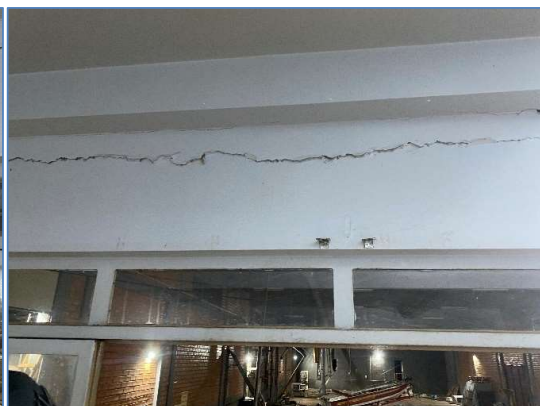
Foto 23: vista interna da área administrativa. Danos nas paredes, rachaduras, infiltrações, mau estado de conservação.
