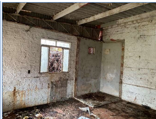
Foto 27: vista do salão, deterioração dos revestimentos e pisos, infiltrações, falta de conservação e manutenção.
