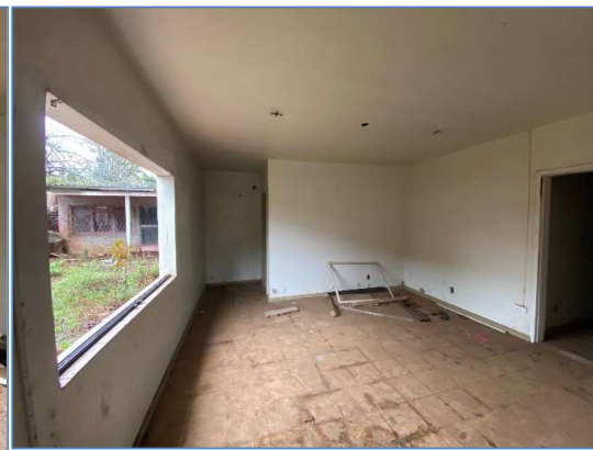
Foto 21: vista interna da área administrativa. Danos infiltrações generalizadas, danos nos pisos, falta de esquadria de janela, mau estado de conservação.
