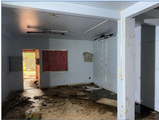
Foto 14: vista interna da área administrativa. Danos nos forros, infiltrações, falta de manutenção, falta de esquadria de janela, mau estado de conservação.
