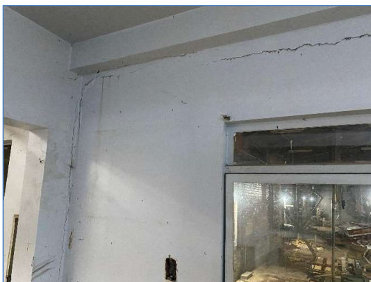
Foto 22: vista interna da área administrativa. Danos nas paredes, rachaduras, infiltrações, mau estado de conservação.
