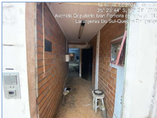
Foto 10: vista interna da área administrativa. Falta de manutenção e mau estado de conservação das paredes, forro e pisos, infiltrações.
