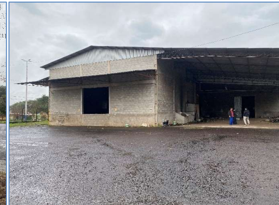
Foto 33: vista do galpão/barracão, mau estado de conservação.
