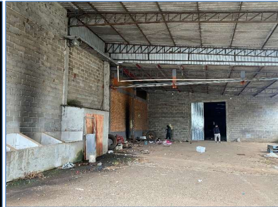
Foto 44: vista interna da cobertura anexa ao galpão, mau estado de conservação, infiltrações.
