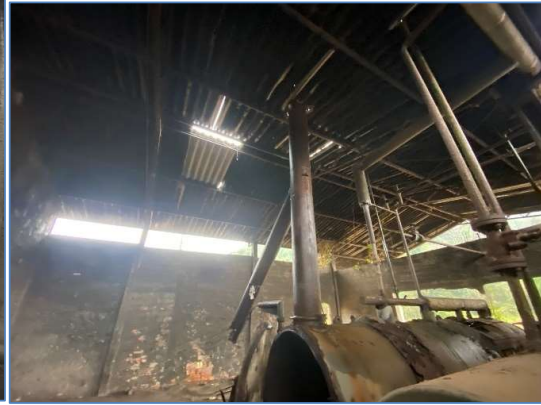
Foto 48: vista interna da casa da caldeira, mau estado de conservação, telhas trincadas, infiltrações.
