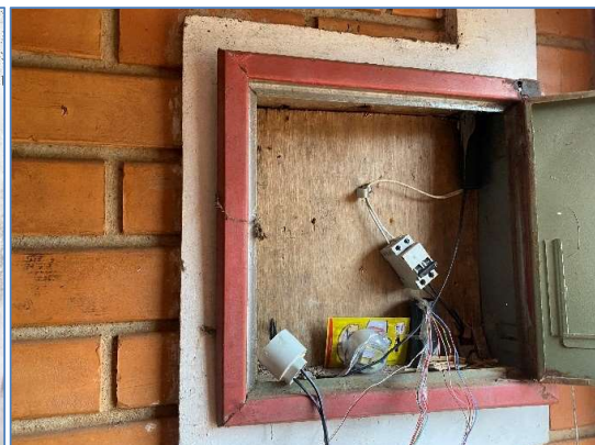
Foto 11: vista interna da área administrativa. Danos nas instalações elétricas, falta de disjuntores e enfição.
