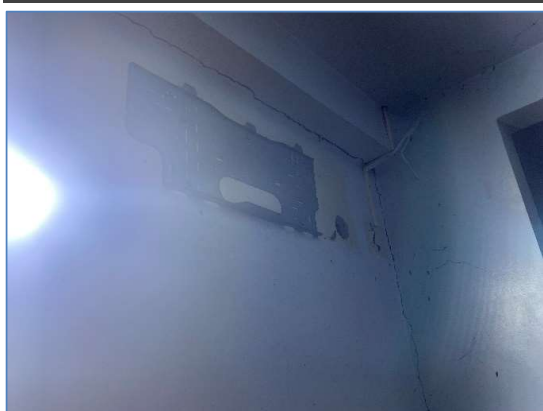
Foto 24: vista interna da área administrativa. Danos nas paredes, rachaduras, infiltrações, mau estado de conservação.
