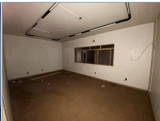
Foto 19: vista interna da área administrativa. Danos infiltrações generalizadas, falta de esquadria de janela, mau estado de conservação.
