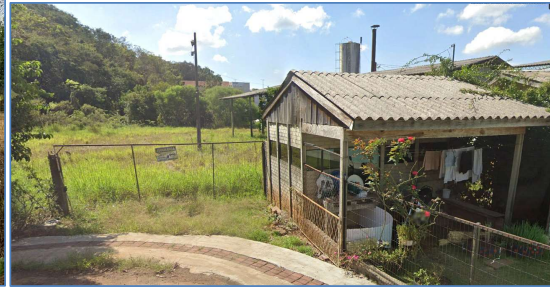
Foto 31: vista do vestiário e guarita, falta de manutenção, mau estado de conservação.
