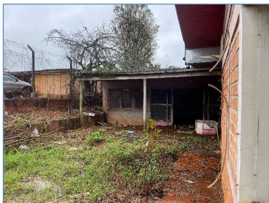
Foto 26: vista do salão, deterioração e falta de conservação e manutenção.
