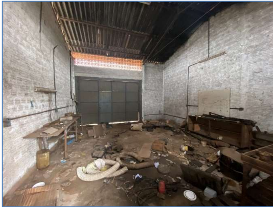
Foto 49: vista interna da oficina, mau estado de conservação, telhas trincadas, infiltrações.
