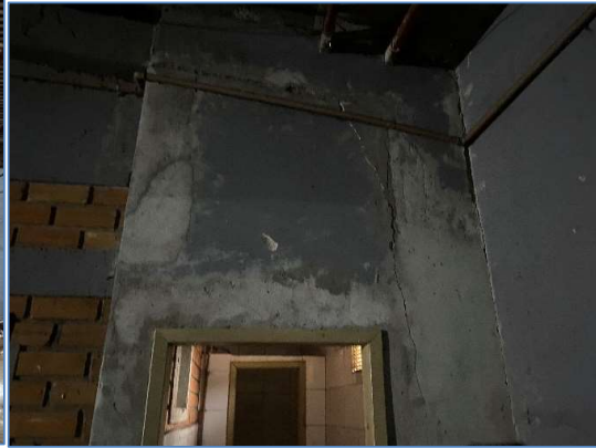
Foto 42: vista interna do galpão/barracão, mau estado de conservação, infiltrações, rachaduras.
