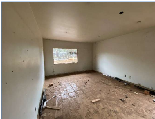
Foto 20: vista interna da área administrativa. Danos infiltrações generalizadas, danos nos pisos, falta de esquadria de janela, mau estado de conservação.
