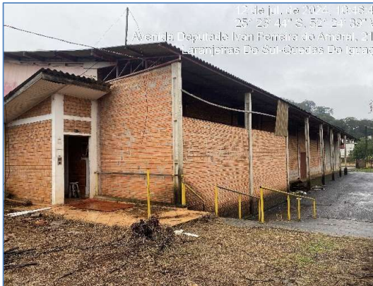
Foto 32: vista do galpão/barracão, mau estado de conservação.
