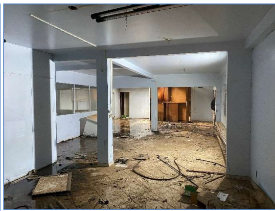
Foto 13: vista interna da área administrativa. Danos nos forros, infiltrações, falta de manutenção, mau estado de conservação.
