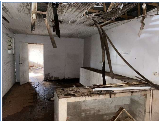
Foto 25: vista interna da área administrativa. Danos nos forros, danos no telhado, infiltrações generalizadas, deterioração do madeiramento, mau estado de conservação
