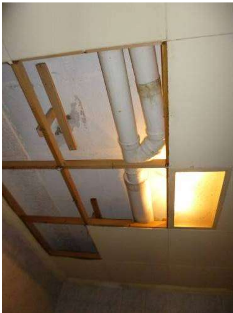
Detalhe do forro danificado no teto do banheiro da suíte.
