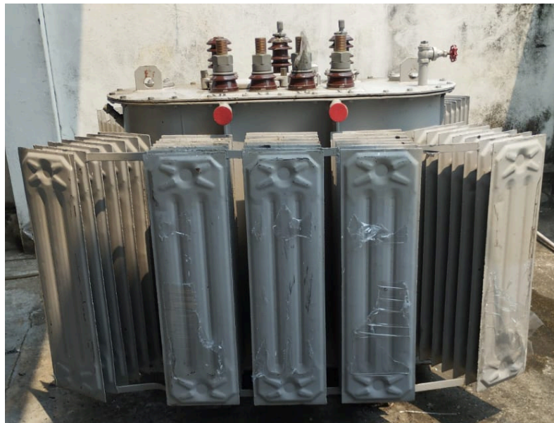
Figura 4 - Transformador 500kVA CEMEC, ano 1987
