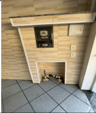
MEDIDOR DE ENERGIA ELÉTRICA/HIDRÔMETRO
