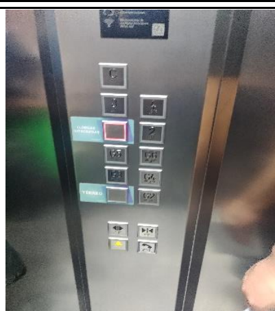
Painel do elevador
