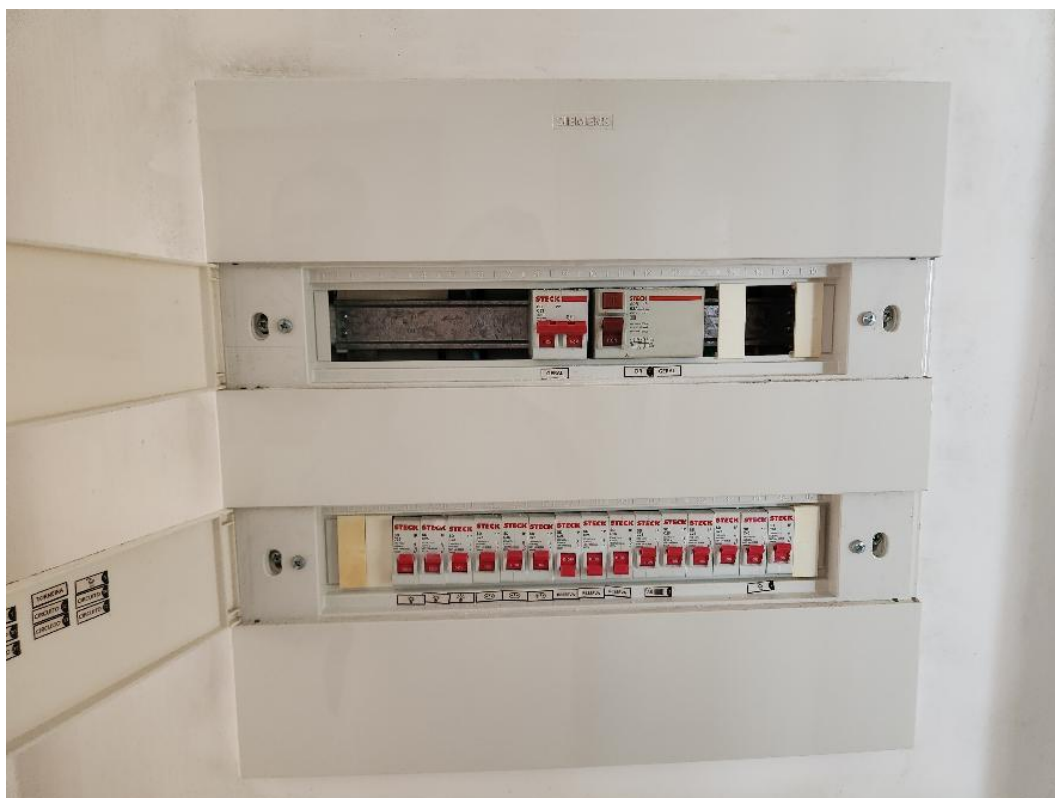
Detalhe do quadro de distribuição elétrica.
