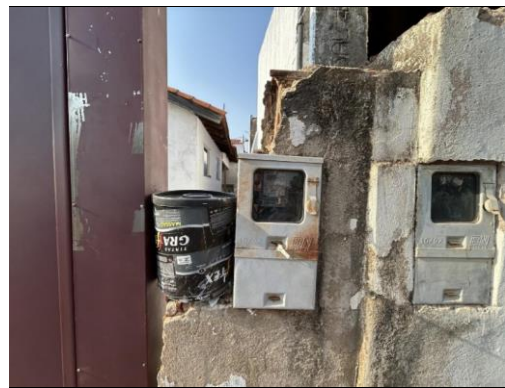
MEDIDOR DE ENERGIA ELÉTRICA
