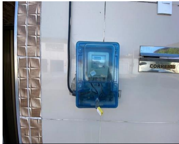
MEDIDOR DE ENERGIA
