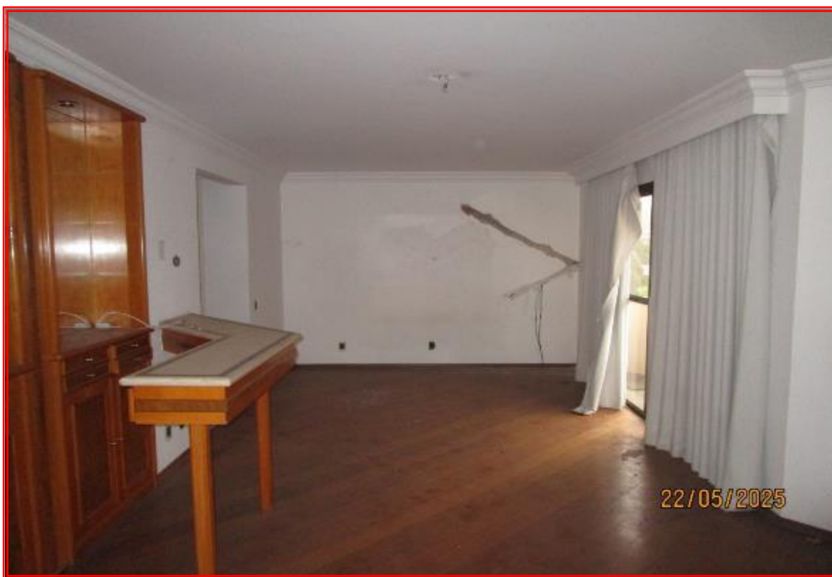
Foto n° 25: Vista geral do living (sala de estar), com detalhe para o bar à esquerda e, aos fundos, a parede danificada próximo a porta da sacada.
