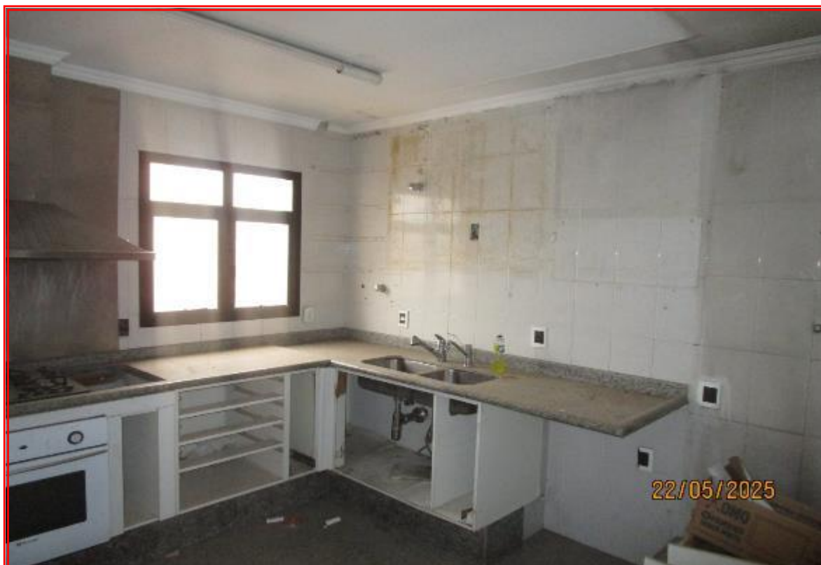
Foto nº 41: Vista parcial da cozinha tomada de outro ângulo, onde se observa o estado do armário de gabinete e revestimento cerâmico de parede.
