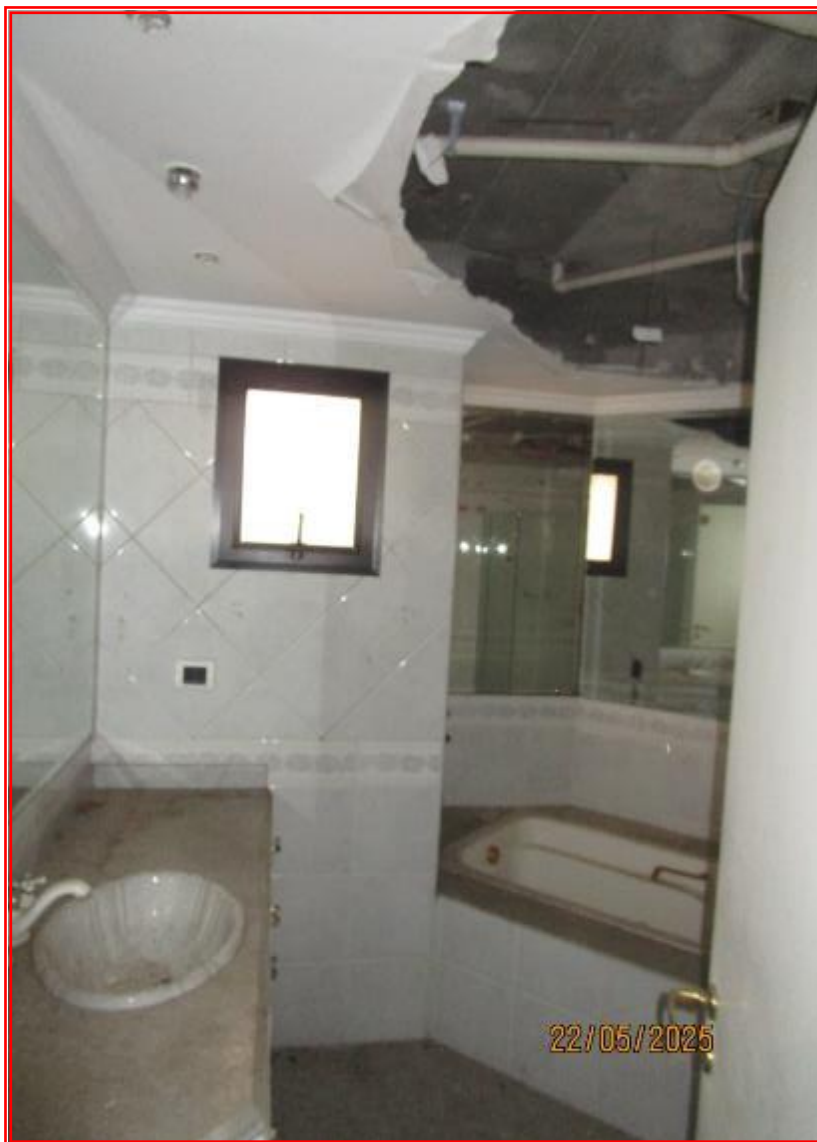
Foto nº 39: Vista parcial do banheiro da suíte, com detalhe para o forro de gesso danificado.
