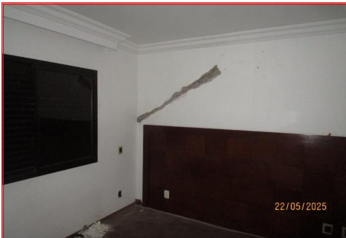
Foto n° 38: Vista parcial da suíte máster, com detalhe para a parede danificada.
