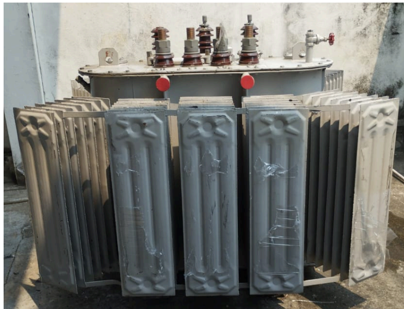
Figura 4 - Transformador 500kVA CEMEC, ano 1987
