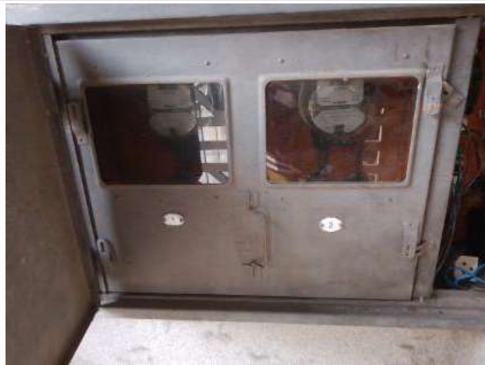
2 Medidores de eletricidade
