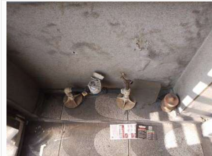
1 medidor de água
