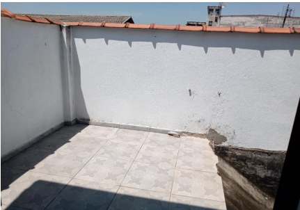
Representação Varanda / Sacada Descrição Data Foto 27/10/2022
