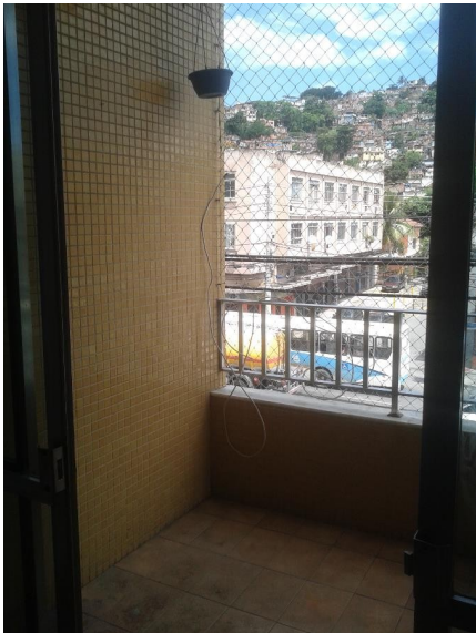
Representação Varanda / Sacada Descrição Data Foto 07/02/2018
