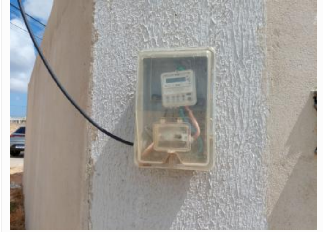
Medidor de energia
