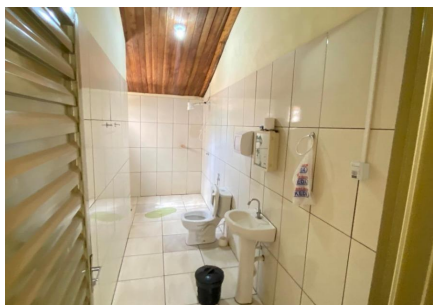
Representação Banheiro Descrição Data Foto 26/10/2022
