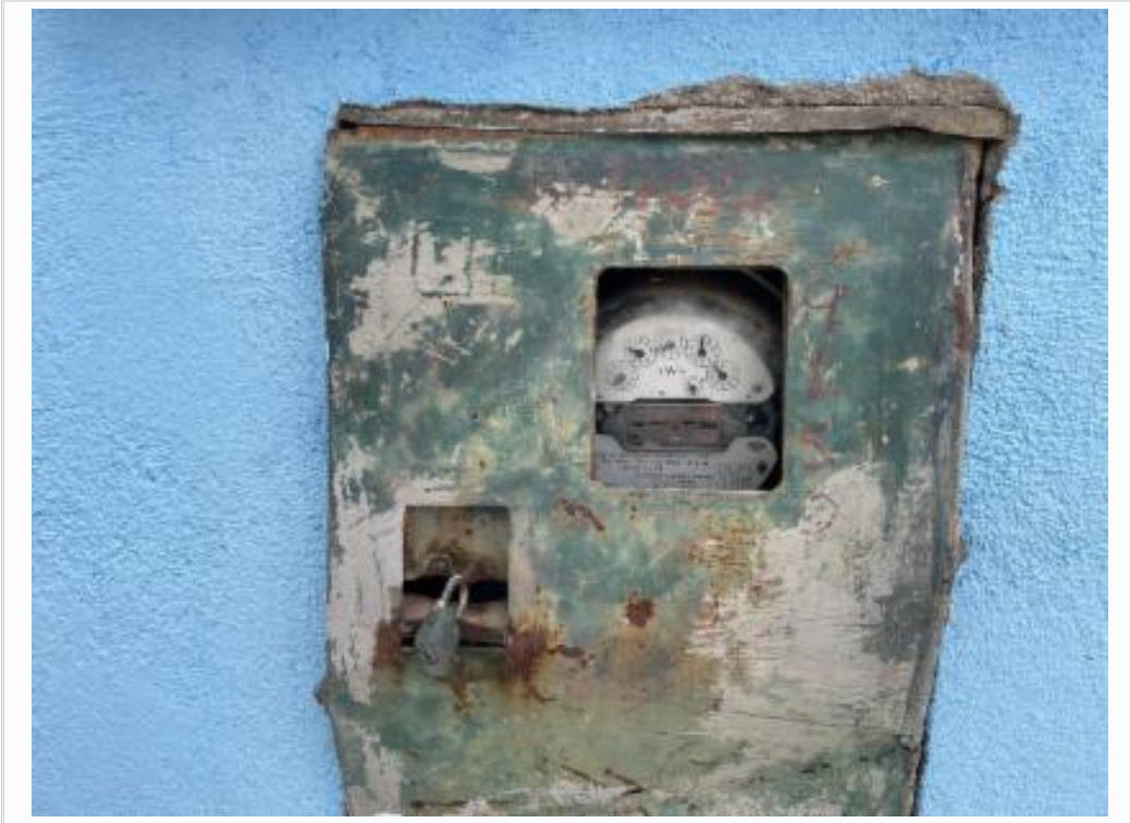
Medidor de energia
