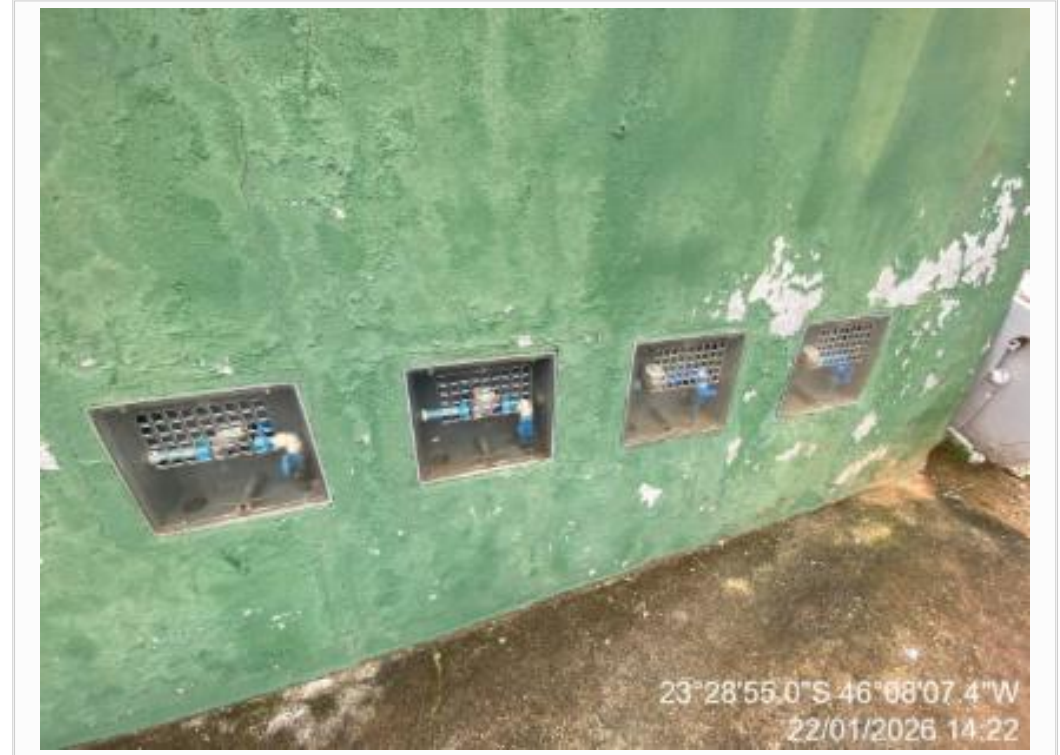
MEDIDOR DE ÁGUA
