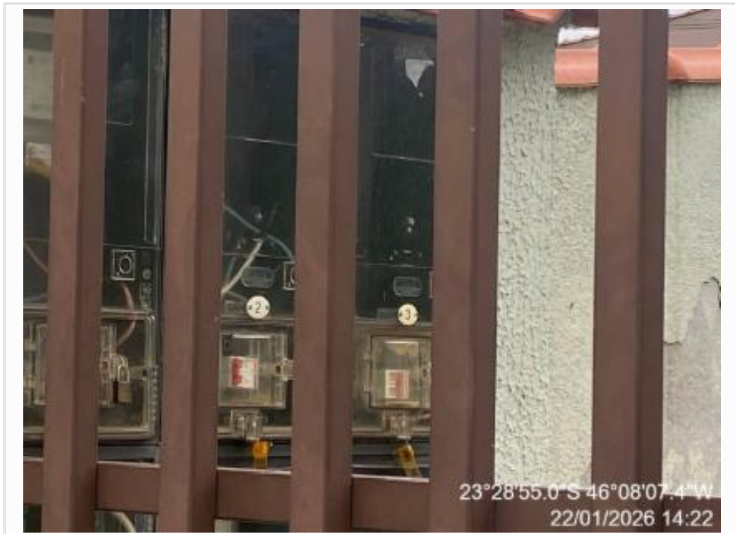
MEDIDOR DE ENERGIA
