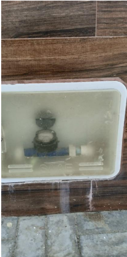
Representação Fachada Principal Descrição Medidor de água Data Foto 23/11/2023
