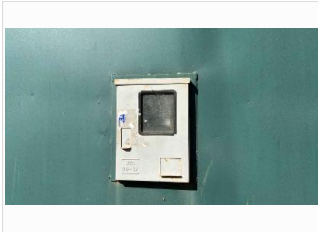
Medidor de energia
