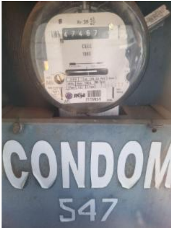
Medidor unico de energia
