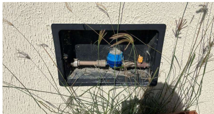
Representação Fachada Principal Descrição Medidor Água Data Foto 05/04/2024
