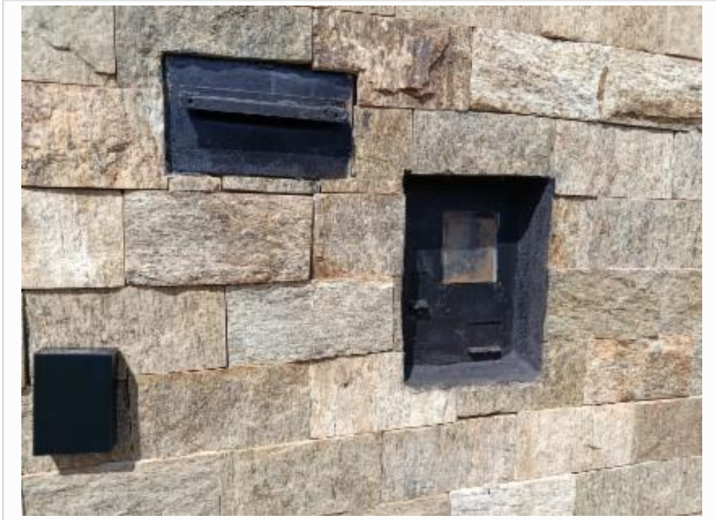
Medidor de energia
