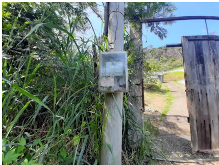
Representação Fachada Principal Descrição Medidor de Energia Data Foto 11/04/2022
