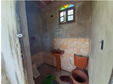
Representação Banheiro Descrição Data Foto 11/04/2022
