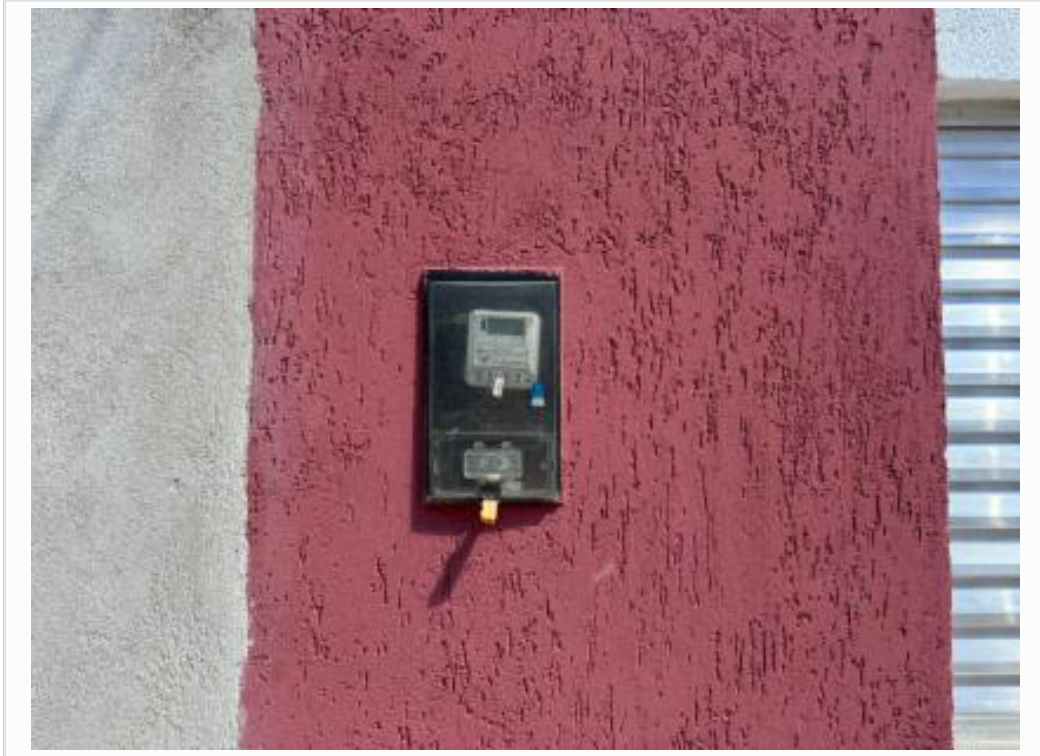
Medidor de energia
