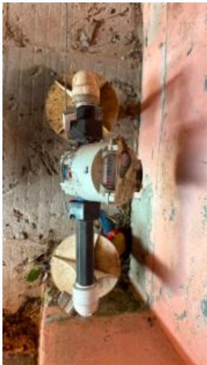
Medidor de água
