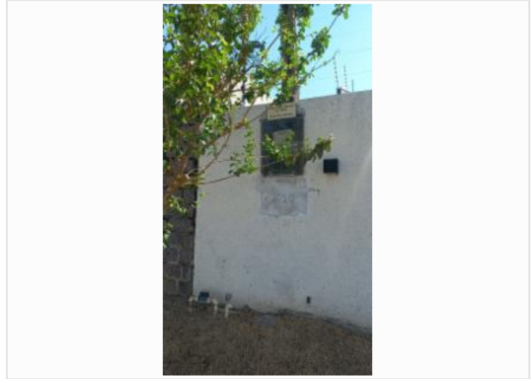
Medidor de energia
