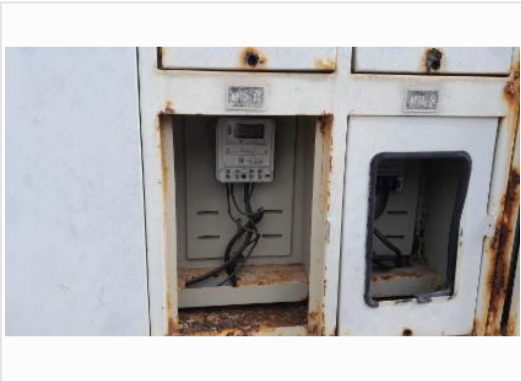
MEDIDOR DE ENERGIA
