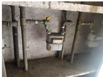
Representação CPD Descrição Medidor de Gás Data Foto 28/04/2020
