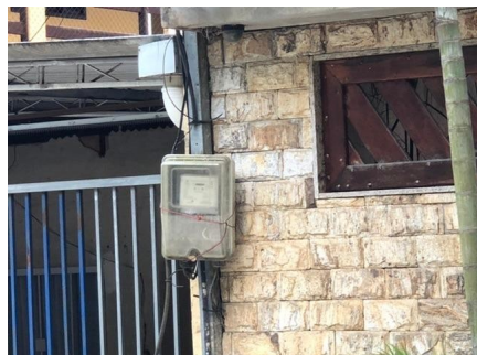
Representação Fachada Principal Descrição Medidor de energia Data Foto 28/10/2020
