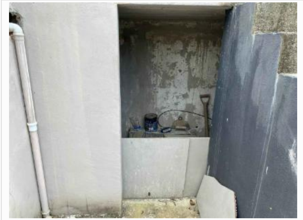
SALA DE MÁQUINAS
