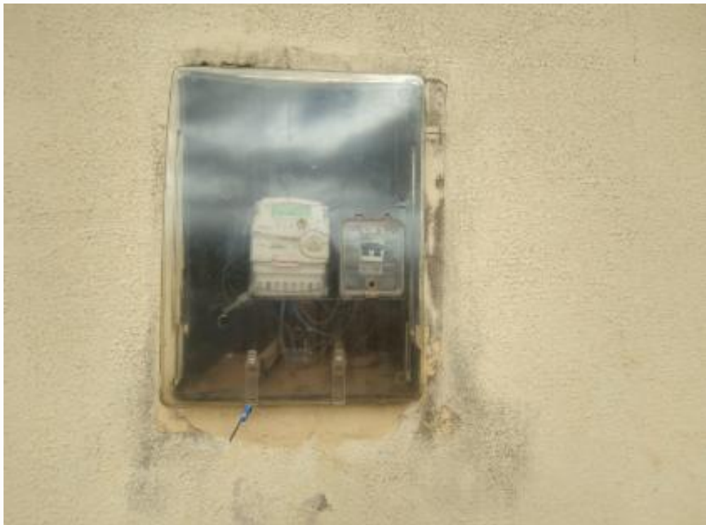
MEDIDOR DE ENERGIA
