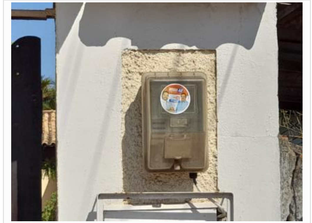
Medidor de energia
