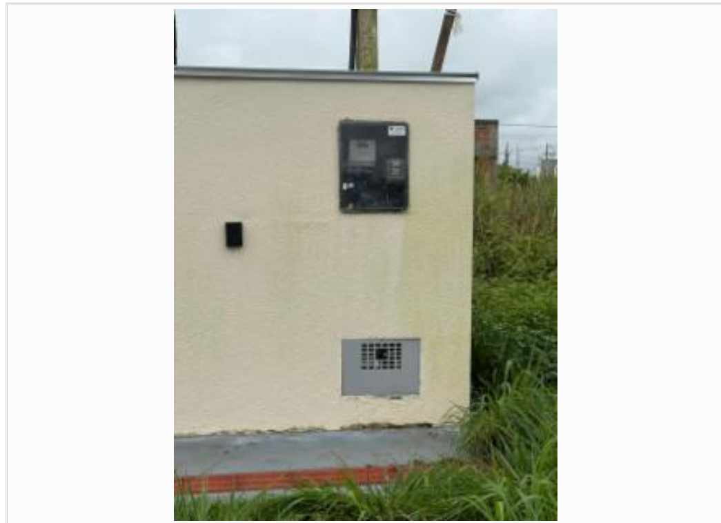
Medidores de água e energia
