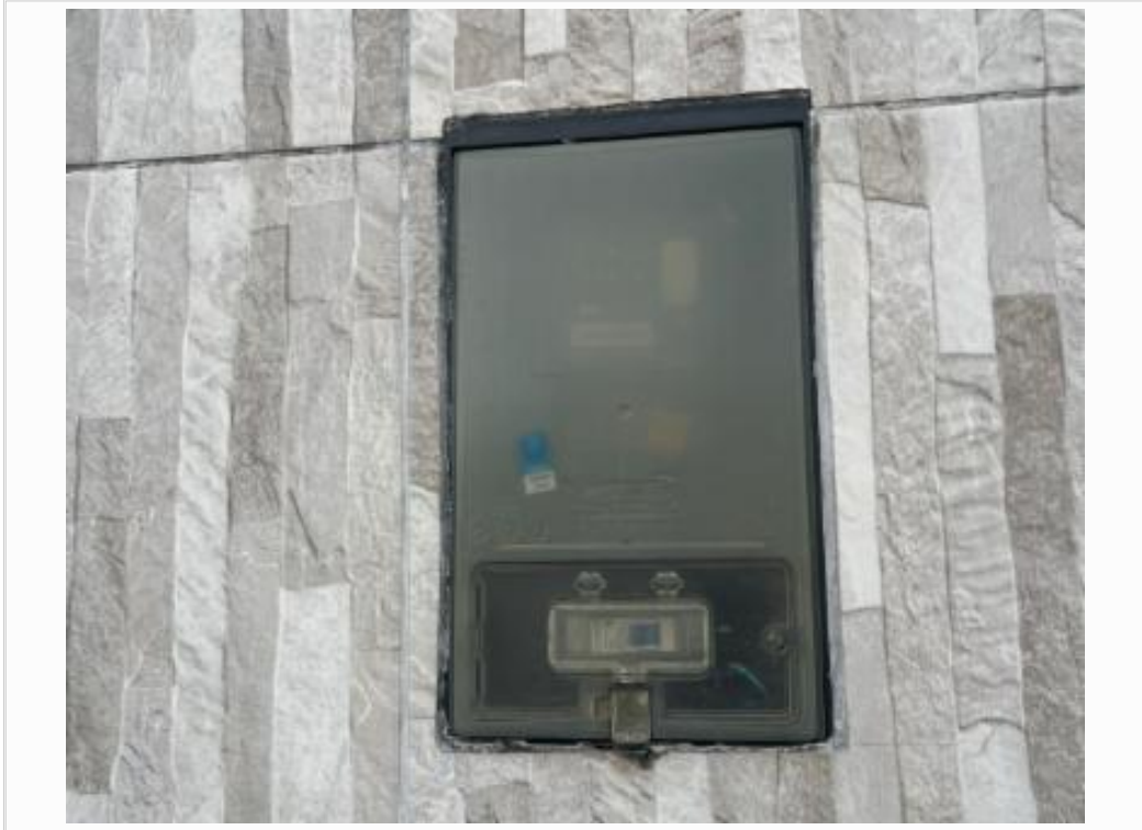
Medidor de energia
