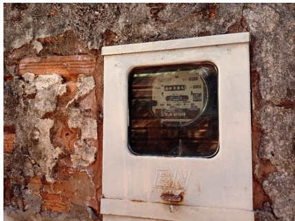
Representação Fachada Principal Descrição Medidor de energia Data Foto 27/06/2022
