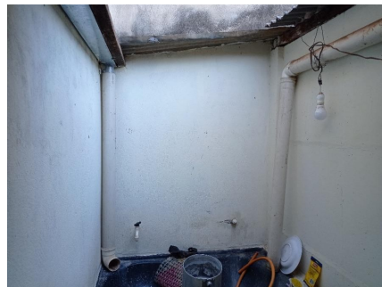
Representação Área de Serviço Coberta Descrição Telha de fibrocimento exaurida Data Foto 27/06/2022
