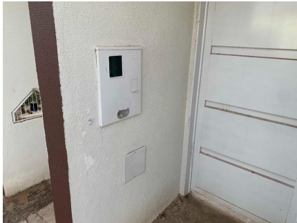
Representação Descrição MEDIDORES Data Foto 02/06/2021
