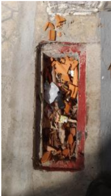
caixa de distribuicao de rede de água I.
