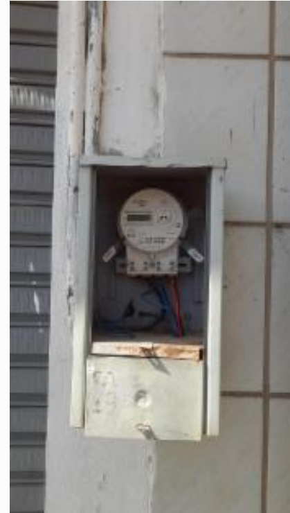
foto quadro de energia da residencia
