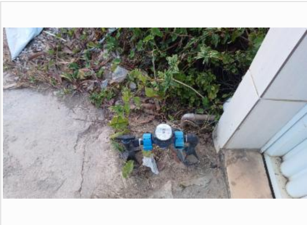
Medidor de agua
