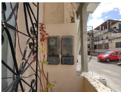
Representação Descrição MEDIDORES Data Foto 13/08/2021
