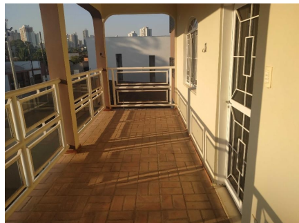
Representação Varanda / Sacada Descrição Data Foto 20/08/2021
