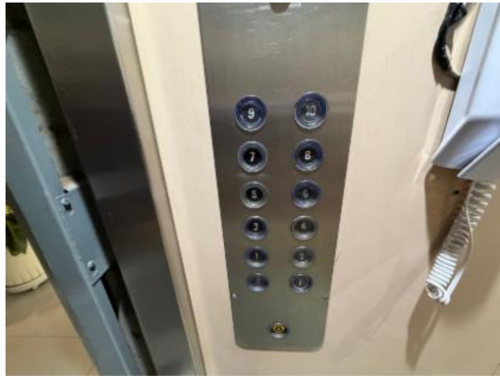
PAINEL DO ELEVADOR
